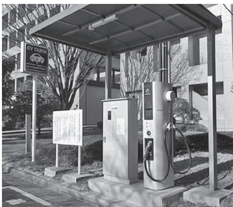
加須市役所内電気自動車用充電設備
