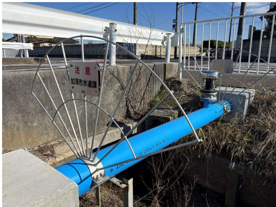
写真 1-1 市内の水道管
