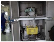
処理施設(機械設備の劣化・大越地区)
