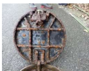
管路施設(マンホール蓋の劣化・大越地区)
