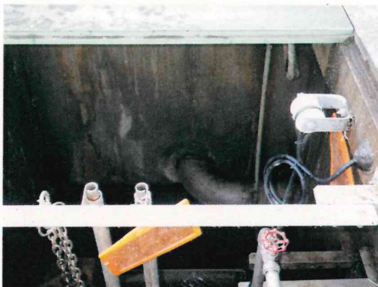
サンプリングポンプ槽
