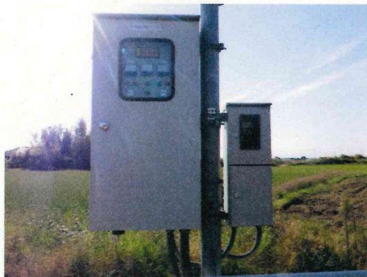
(制御盤設置状況)
