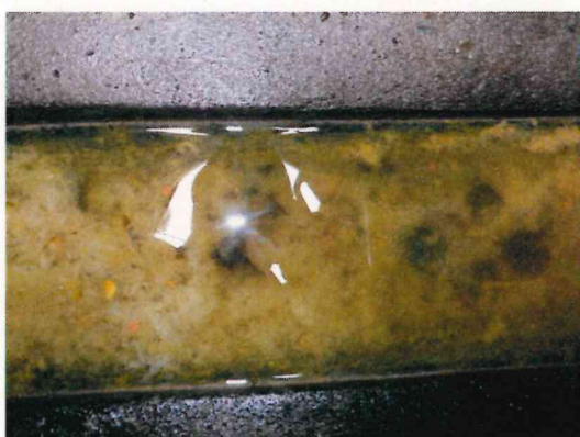
(インバート部汚水滞留 S-4)
