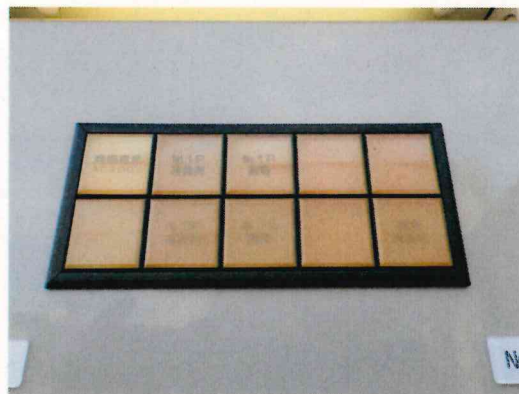
(表示ランプ類汚損有)
