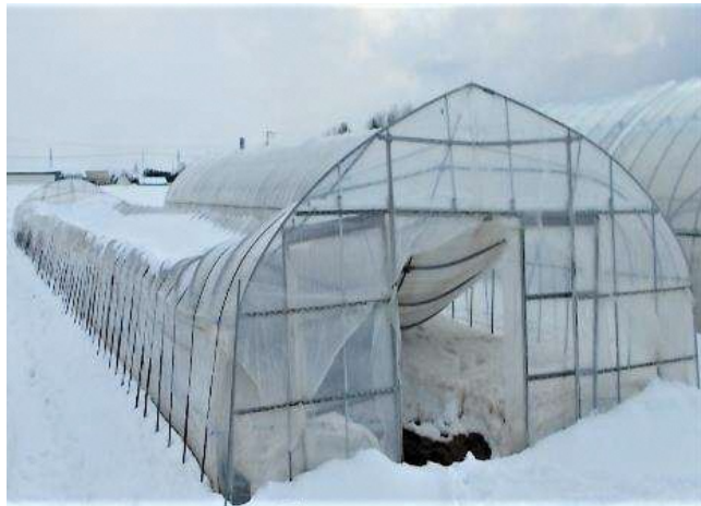
＜雪による被害の様子＞
