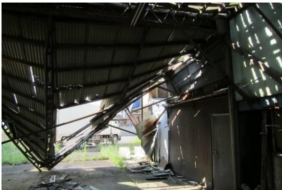
屋根や外壁等が外見上大きく破損したまま、放置されている。
