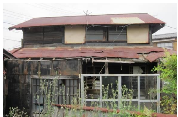
多数のガラスが割れた(壊れた)まま放置されており、不特定者が容易に侵入できる状態。
