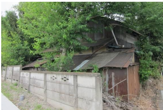
立木等が建物の全面を覆うほどまで繁茂し、道路等にはみ出していて、通行を妨げている。
