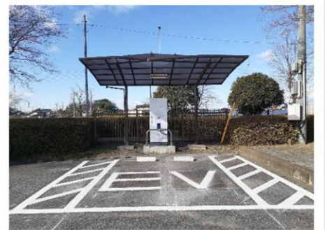
「道の駅」への急速充電器の設置
