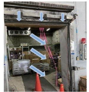
写真1 冷蔵庫扉周辺の空気流れ
