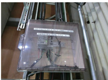
省エネ補助金で導入した電力監視システムの一部
