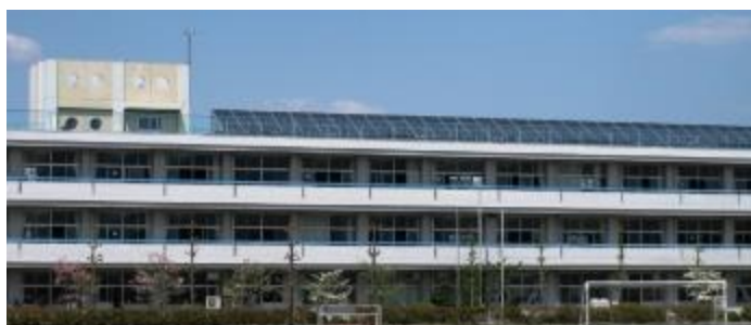
騎西中学校 太陽光発電システム
