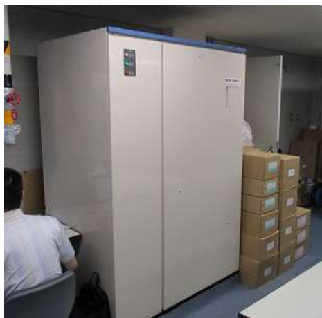
〔電算室空調機〕
