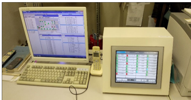
中央監視システム
