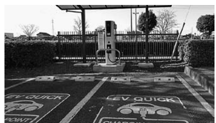
童謡のふる里おおとね農業創生センター内電気自動車用充電設備
